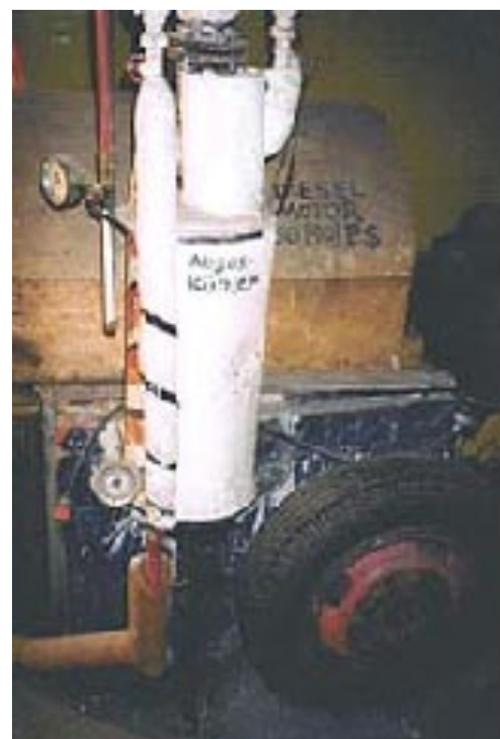
Abb. 27 Erstes BHKW in Selbstbauweise 1981 Quelle: http://www.ufafabrik.de
