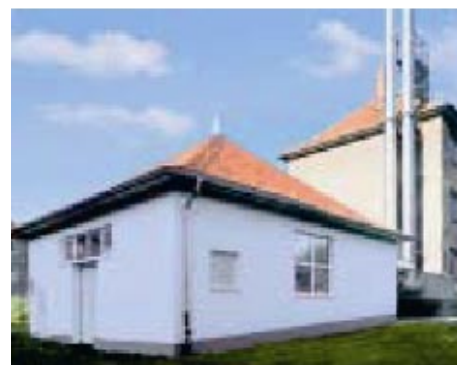
Abb. 4 Kesselanlage und Nahwärmenetz, Westphalweg 15 c Die Anlage liegt im Innenhof eines dreigeschossigen Gebäudekomplexes mit insgesamt 574 Wohneinheiten. Sie besteht aus zwei Niedertemperaturkesseln der Firma Buderus (Kesselleistung jeweils 1.320 kW) und ist auf die Verfeuerung von Erdgas mit Gebläsebrennern der Firma Riello ausgelegt. Aus dieser eigenen Kesselanlage liefert die BEWAG die Wärme und verteilt sie über ihr Nahwärmenetz bis zu den Hausübergabestationen. Quelle: BewagWärme - Optimale Versorgung direkt vor Ort, Feb. 2002
