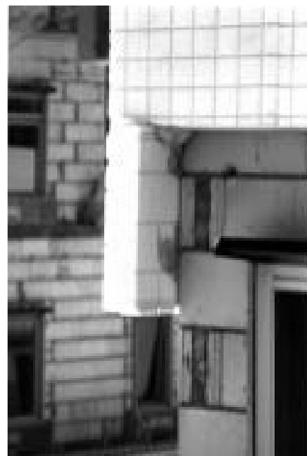
Abb. 33 16 cm starke „Thermohaut“ auf der Außenwand Quelle: IWU: „Niedrigenergiesiedlung Distelweg“ in Niederhausen, Darmstadt 1994
