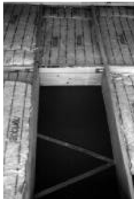
Abb. 36 25 cm Dämmung zwischen den Dachsparren Quelle: IWU: „Niedrigenergiesiedlung Distelweg“ in Niederhausen, Darmstadt 1994
