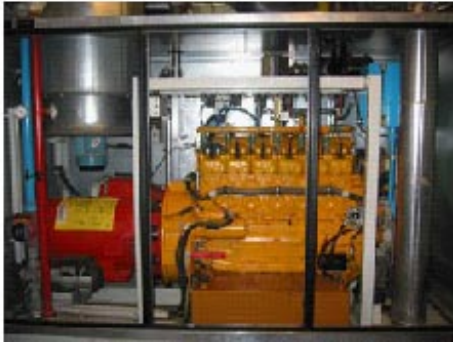
Abb. 29 Modernes Blockheizkraftwerk 1993 Quelle: http://www.ufafabrik.de
